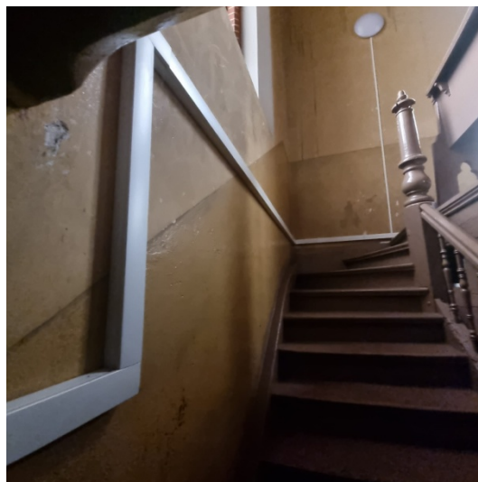
Fot. 6 Widoczne plastikowe maskownice instalacji elektrycznej
