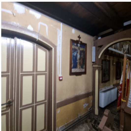
Fot. 5 Widoczne plastikowe maskownice instalacji elektrycznej
