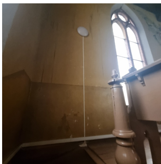
Fot. 8 Widoczne plastikowe maskownice instalacji elektrycznej
