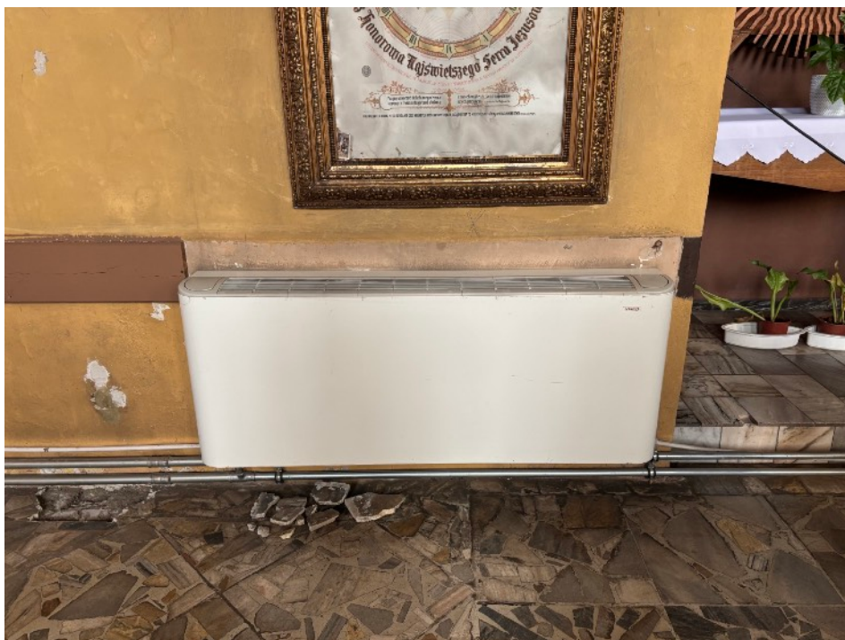
Fot. 15 Grzejnik instalacji ogrzewania gazowego zamontowany we wnętrzu kościoła.
