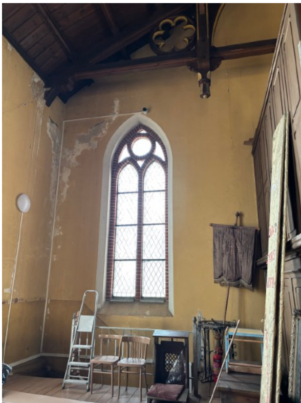
Fot. 9 Fragment narożnika ścian przy emporze – widoczne zniszczenia tynków, łuszcząca się lamperia oraz liczne maskownice instalacyjne umieszczone na powierzchni ścian.
