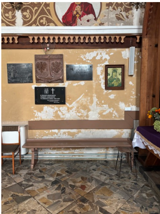
Fot. 12 Fragment ściany z licznymi uszkodzeniami: odspojenia i łuszczenie farby, ślady po dawnych instalacjach, brakujące elementy drewnianego lambrekinu oraz ubytki farby powyżej. Wzdłuż ściany widoczne szerokie maskownice kablowe oraz rury ogrzewania gazowego prowadzone nad posadzką.
