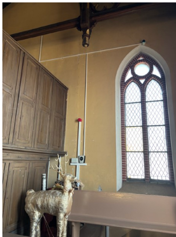
Fot. 10 Ściana nad prospektem organowym. Widoczne maskownice z kablami, obok ślad po dawnym prowadzeniu instalacji – uzupełnienie w tynku wyróżniające się spod warstwy malarskiej. Proponowane miejsce ponownego schowania przewodów, bez konieczności wykonywania nowych bruzd.
