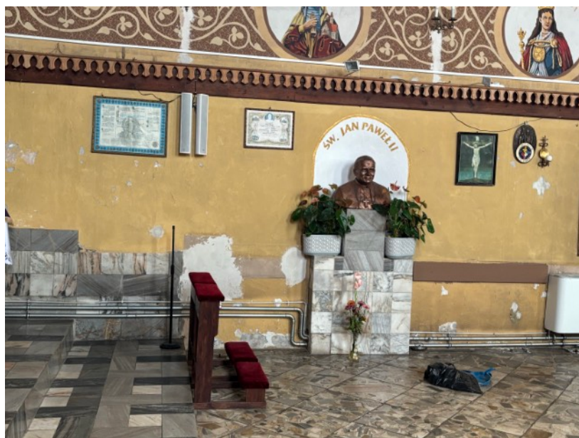
Fot. 11 Fragment ściany bocznej przy stopniach do prezbiterium – liczne łuszczenia farby i cementowe łaty, widoczna instalacja ogrzewania gazowego (rury i grzejnik) oraz maskownica kablowa poprowadzona nad dekoracyjnym fryzem drewnianym-lambrekinem
