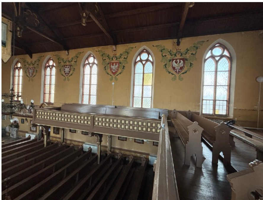
Fot 8. Ściana boczna nawy z widocznymi maskownicami instalacji ppoż., prowadzonymi na powierzchni tynku pomiędzy oknami.
